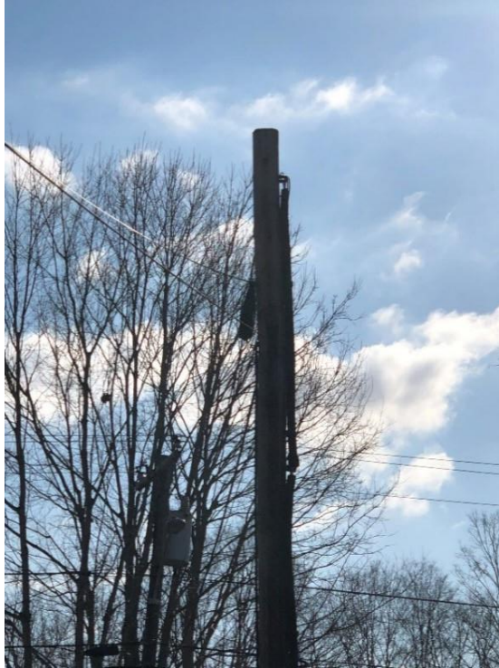
EL-1 Utility Riser Pole
